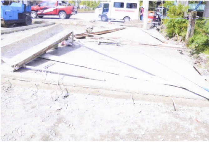
Improper Dowel Bars (substandard)
